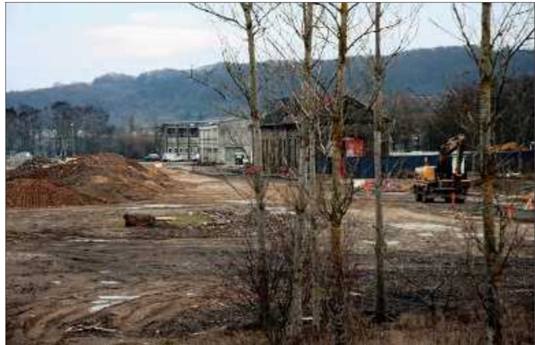
Débutés en décembre dernier, les travaux de viabilisation d'une zone d'activité économique sur le bas de Micheville arrivent à terme. Photo archives Julio Pelaez
